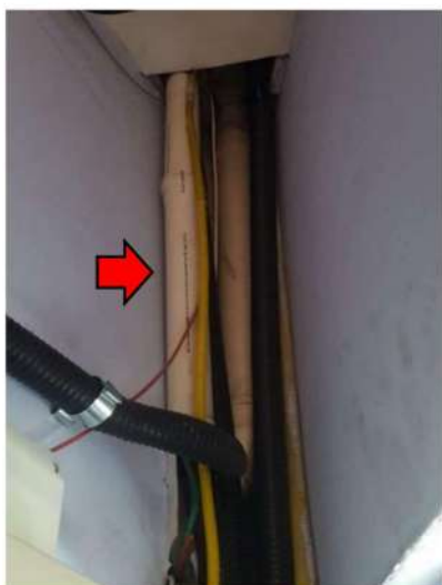
Figura 30 Condutores em tubo pvc, fora de norma
