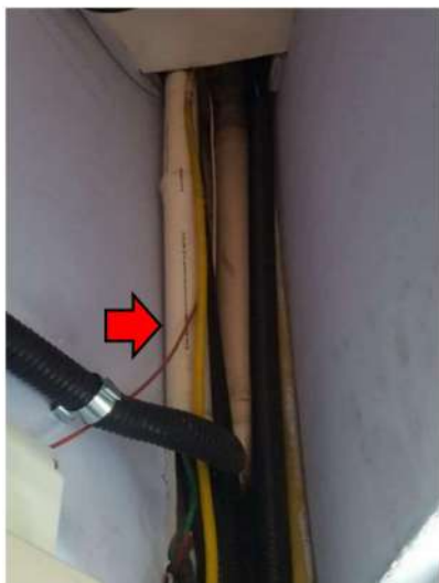
Figura 37 Cabos transportados fora de norma
