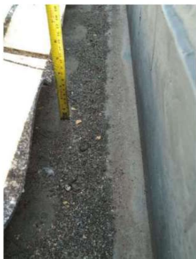
Figura 54 Calha com prof.abaixo do necessário
