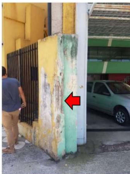
Figura 13 Armadura aparente na fachada
