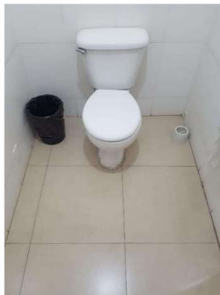
Figura 20 Sanitários a ser readequados
