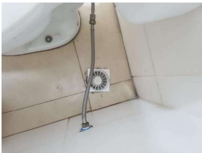
Figura 24 Sanitário a ser readequados
