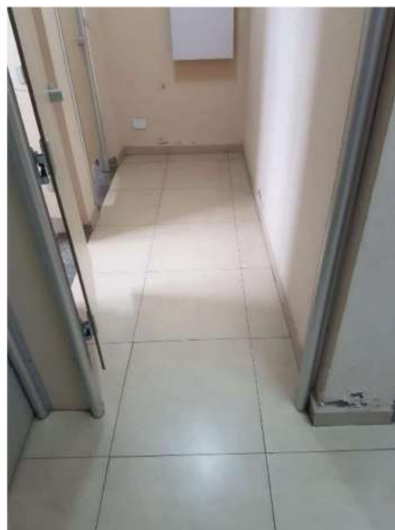
Figura 23 Sanitários a ser readequados
